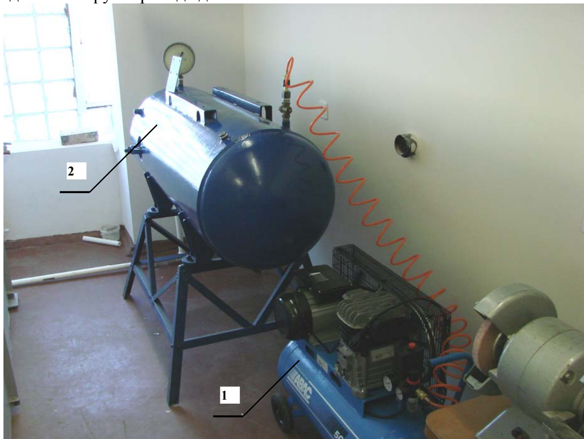
Рисунок 4.21 – Внешний вид компрессора и ресивера воздушной системы установки: 1 – компрессор В2800/50; 2 – воздушный ресивер
