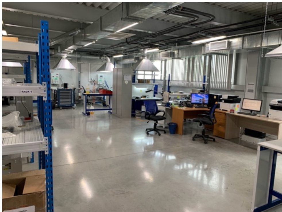
Рисунок 4.25 - Цех обслуживания электрооборудования ВС
